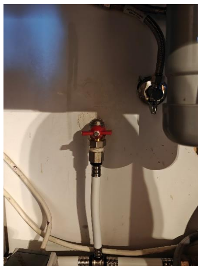
Zamknięty zawór wody pod zlewem w kuchni
