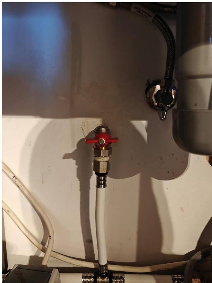
Zamknięty zawór wody w kuchni pod zlewem
