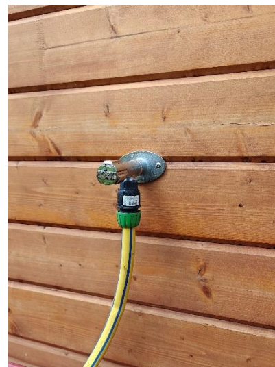
Zawór wody pod oknem kuchennym
